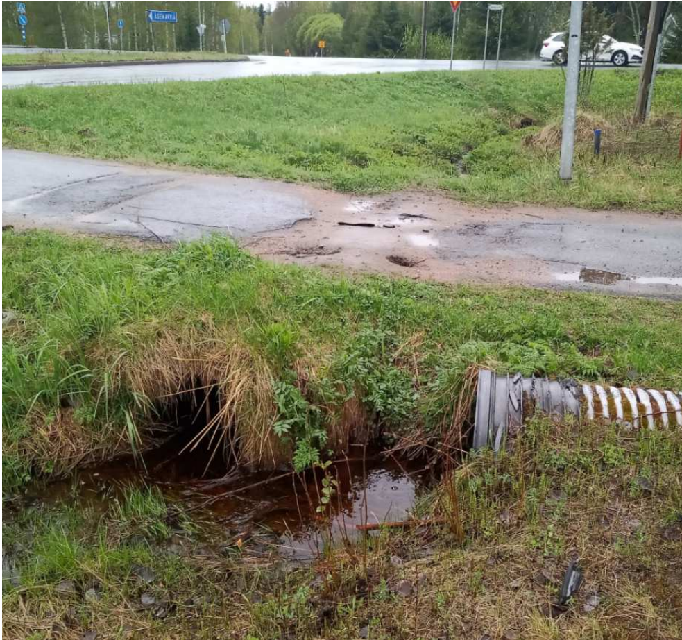
Kuva 4. Kevyen liikenteen väylän alittava nykyinen rumpu, jonka kohdalla päällyste on vaurioitunut.
